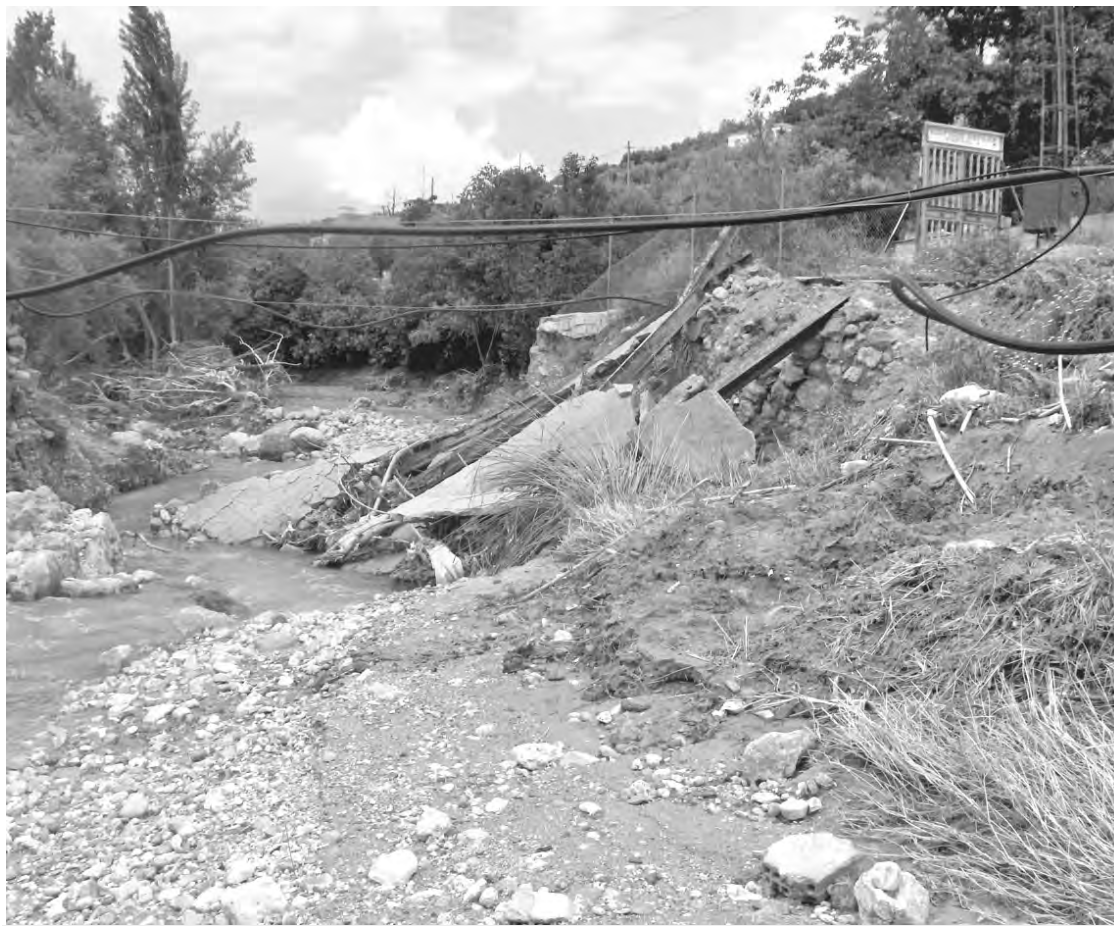
Acumulación de piedras y lodos debido a la tormenta.
