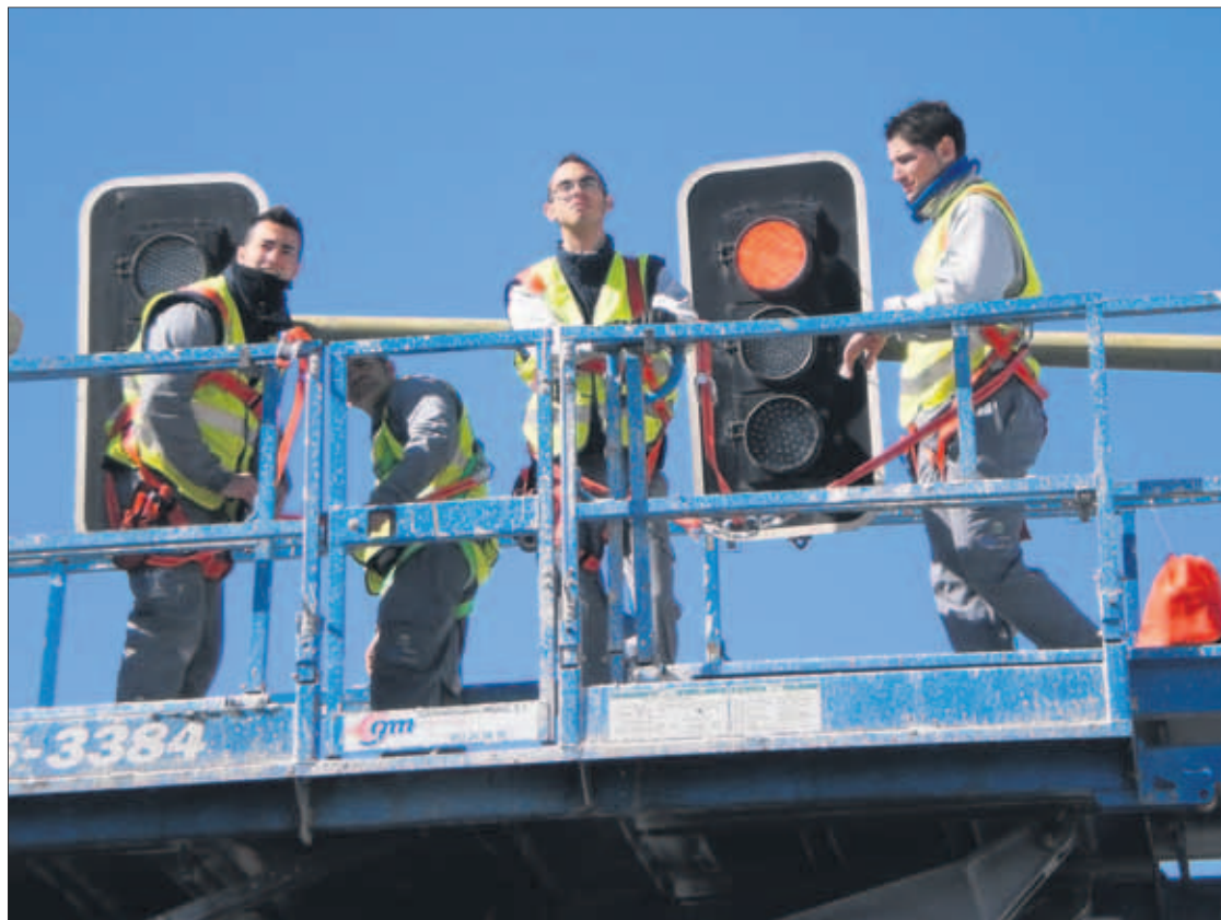
Alumnos de la Escuela Taller de Torredelcampo trabajan en un semáforo del casco urbano.
